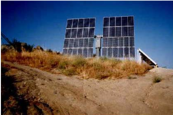
Fig. 1: Seguidor solar con 44 paneles fotovoltaicos (SOLÉNER)
