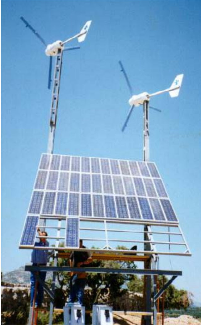
Fig. 4: Una instalación mixta eólico-fotovoltaica
